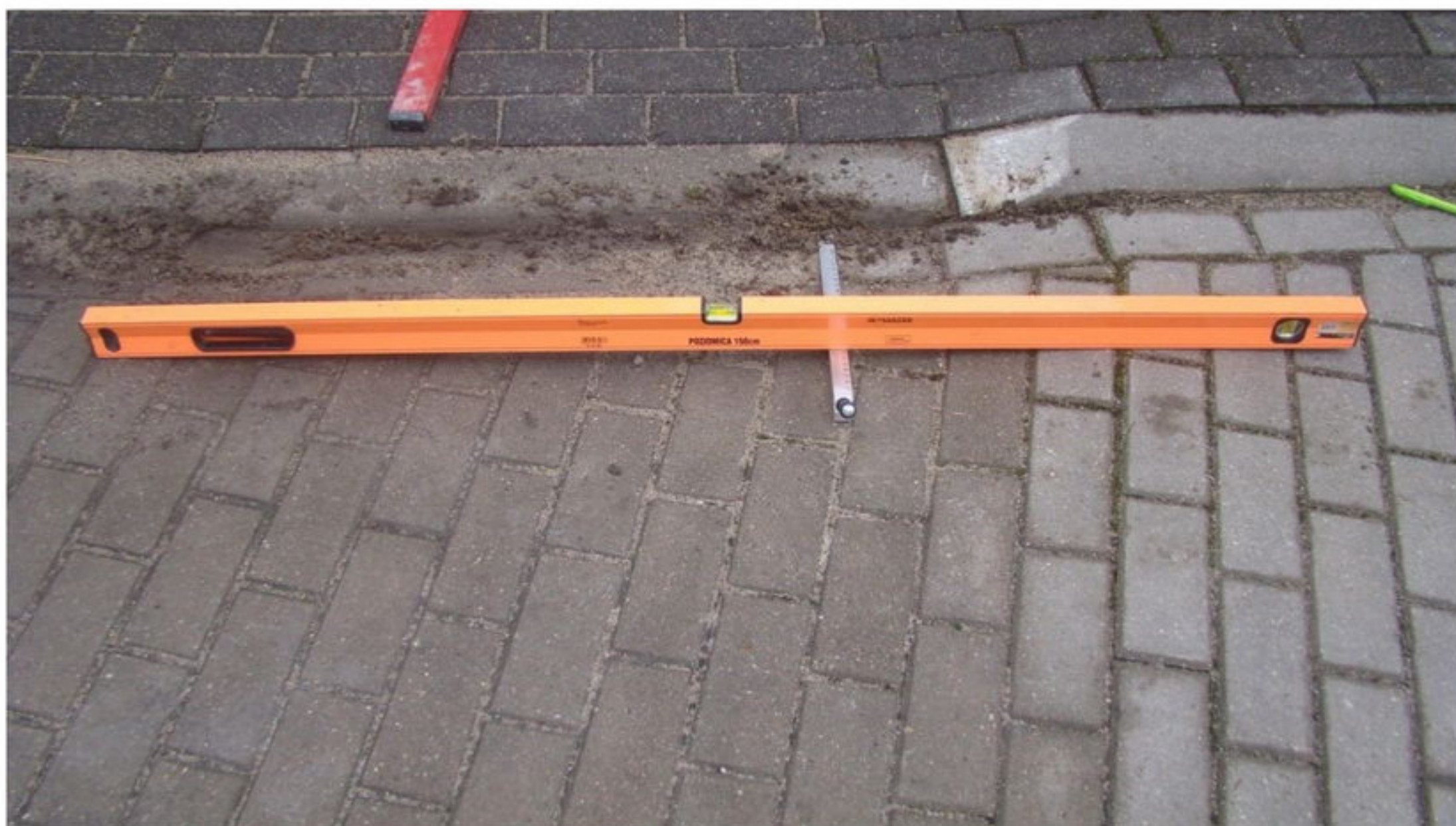
Zdjęcie nr 4. Widok zapadnięcia nawierzchni dojazdowej do miejsc postojowych zlokalizowanych nad garażem podziemnym przy budynku wielorodzinnym ul. [REDACTED] – lewa strona patrząc w kierunku miejsc parkingowych.
