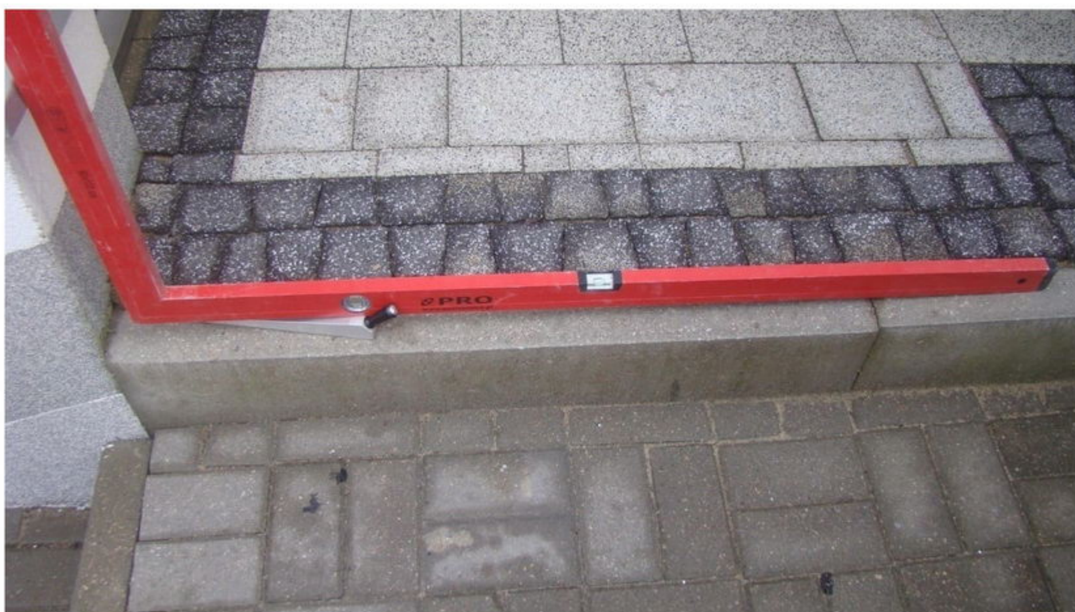
Zdjęcie nr 3. Domiar zaniżenia w płaszczyźnie poziomej stopnia przy schodach zewnętrznych zlokalizowanych przy budynku ul. [REDACTED]
