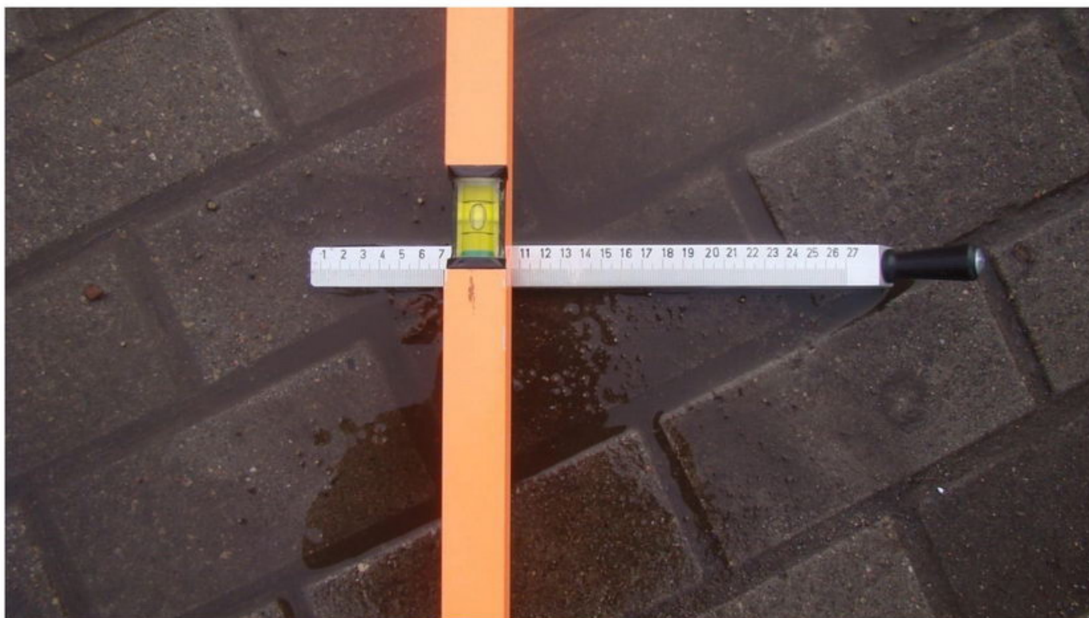
Zdjęcie nr 2. Domiar miejscowego zapadnięcia przy wjeździe nr 2 do budynków wielorodzinnych przy ul. [REDACTED] – pomiar szczelinomierzem wskazuje ok. 10,5mm.
