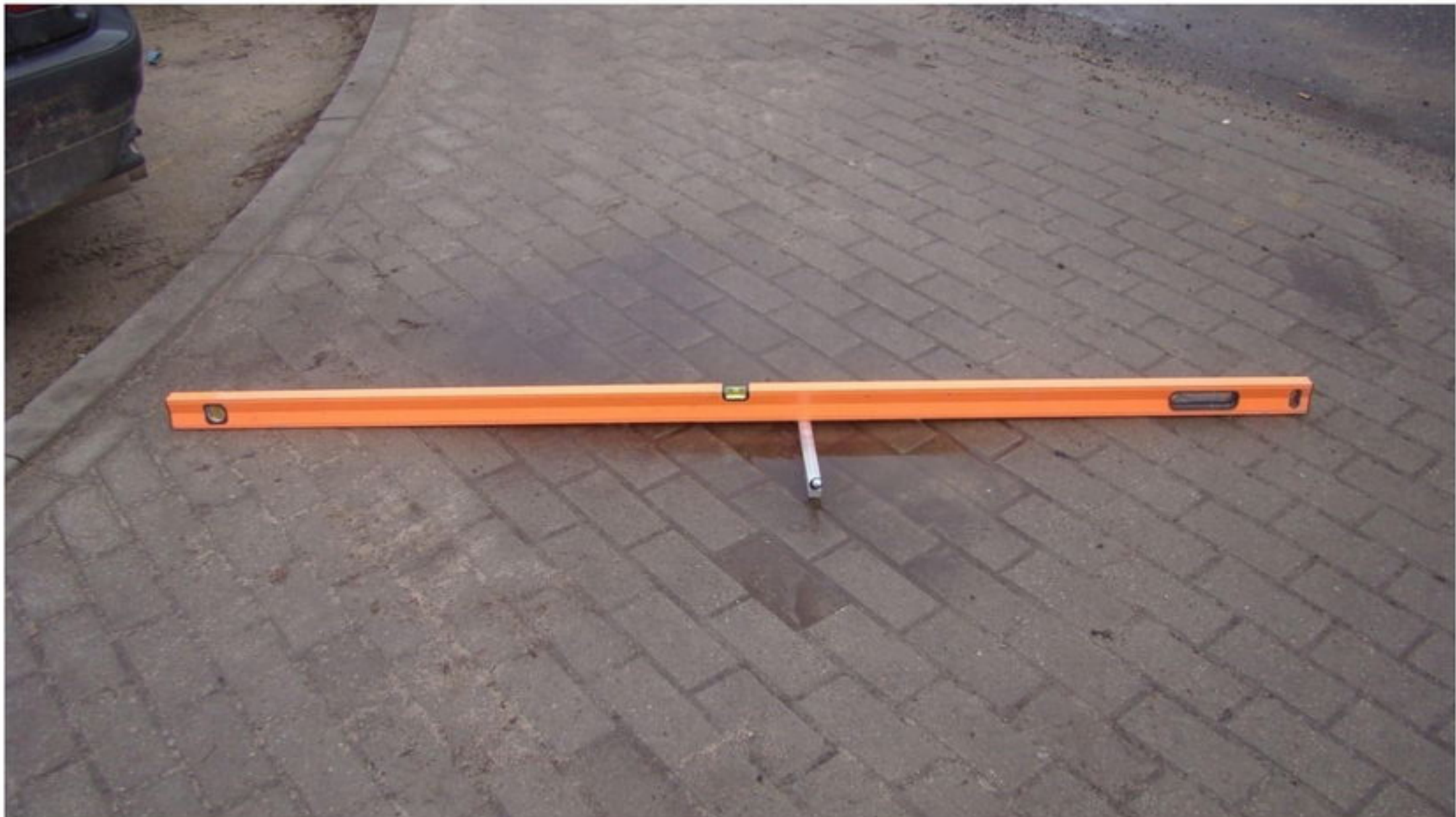
Zdjęcie nr 1. Miejscowe zapadnięcie przy wjeździe nr 2 do budynków wielorodzinnych przy ul. [REDACTED]
